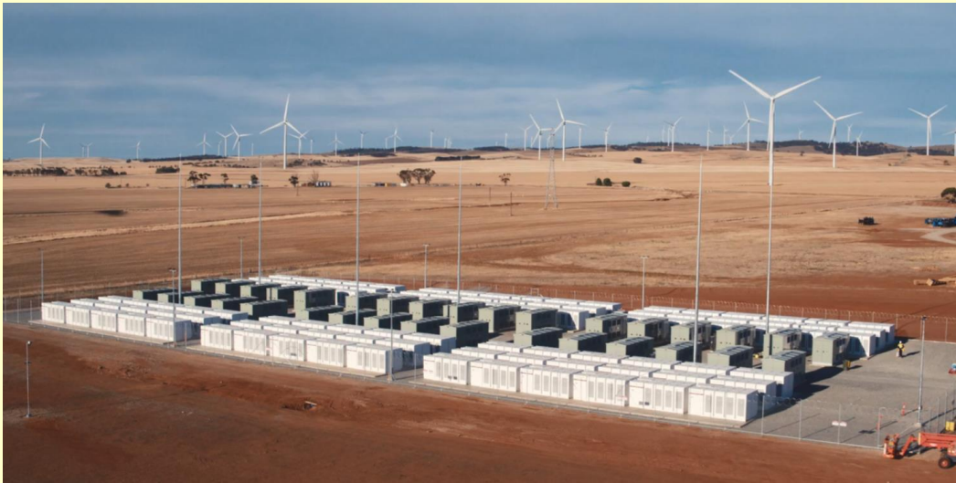
Současné největší bateriové úložiště firmy Tesla v Austrálii: 100 MW, 128 MWh
